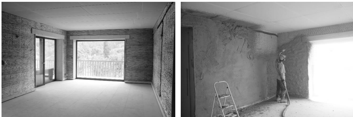
Murs prêts à recevoir l'enduit terre Projection des enduits terre par Noé Solsona (Ca-liclay)
