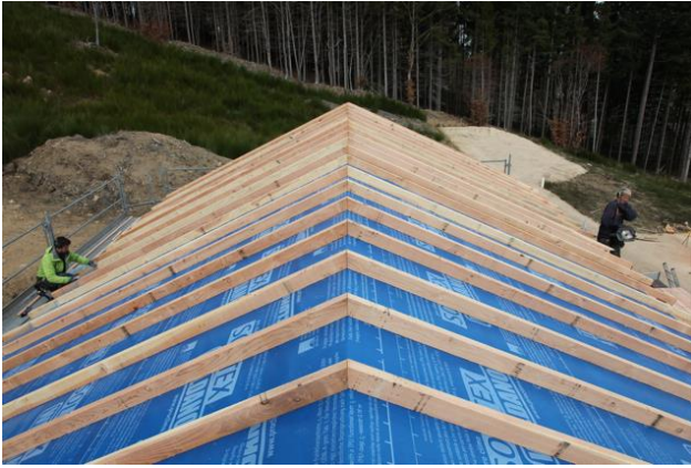
Figure 7 : l'étanchéité air et eau du vissage des chevrons est assurée par la pose en sous-face du chevron d'une bande de caoutchouc butylique double-face proclima Tescon Naidec.
