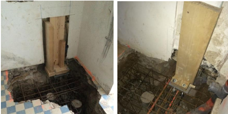
Figure 7 : Mise en place de micro-pieux pour soutenir la construction depuis le rez-de-chaussée
