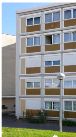
Nez de dalle à nu extérieur
